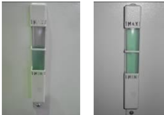
Figure 18 / 19 – Recharge du réservoir
