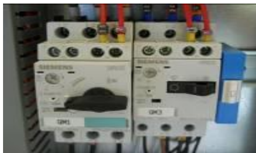
Figura 8 – Interruptores del circuito OFF
