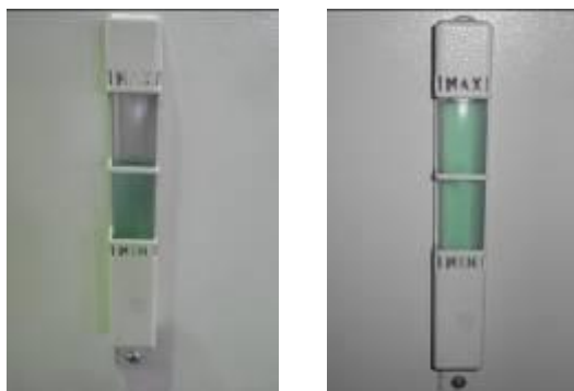
Figura 18 / 19 – Rabbocco del serbatoio
