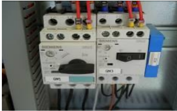
Figure 16 – Interrupteur de la pompe sur ON
