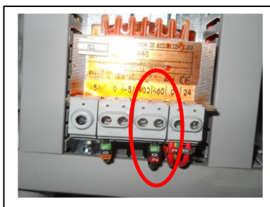
Figura 6 Transformador configurado en 460V
