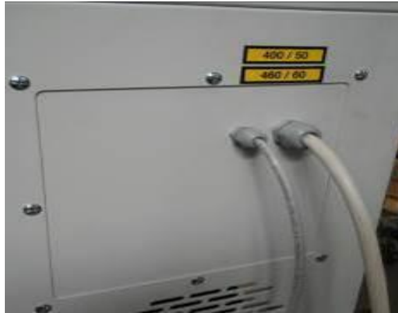
Figura 4 – Piastra per i collegamenti elettrici
