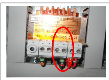
Рис. 6 Трансформатор с 460В
