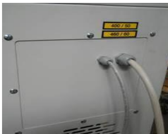
Figura 4 – Placa para conexiones eléctricas
