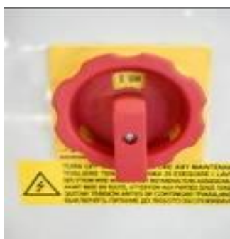
Figura 17 – Interruttore generale su ON
