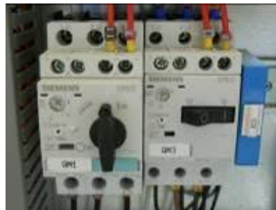
Abbildung 20 – Alle Trennschalter auf ON
