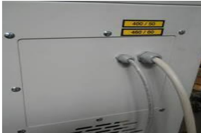
Figure 4 – Plaque pour les raccordements électriques
