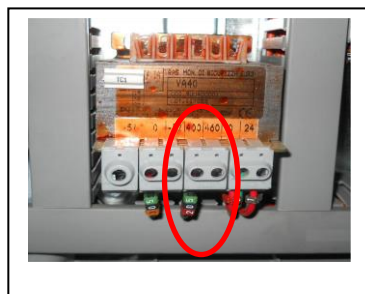
Figura 5 Trasformatore impostato a 400V
