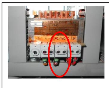
Figura 5 Transformador configurado en 400V
