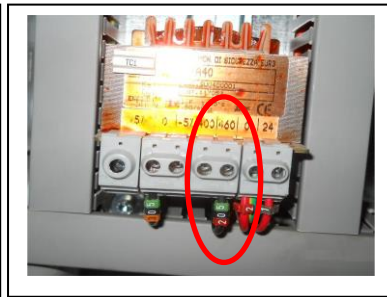
Abbildung 6 Auf 460V eingestellter Transformator
