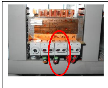
Abbildung 5 Auf 400V eingestellter Transformator
