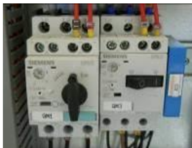
Figure 20 – Tous les interrupteurs de circuit sur ON
