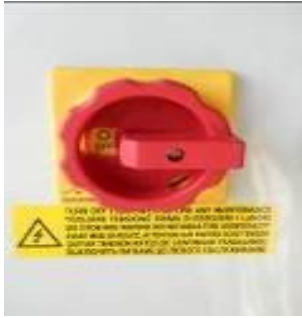
Figura 7 – Interruttore generale OFF
