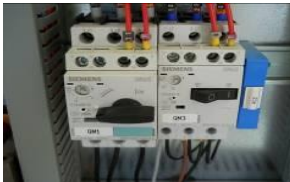
Figura 16 – Interruptor de la bomba en ON
