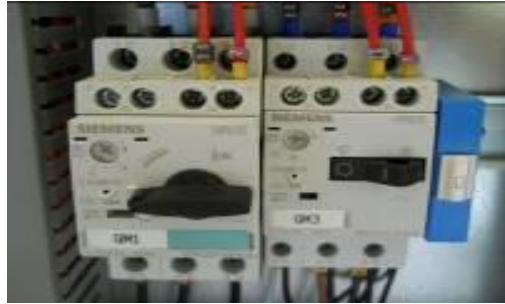
Figure 8 – Interrupteurs de circuit OFF
