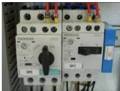
Figura 20 – Interruptores del circuito en ON
