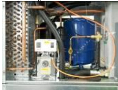
Tubos del refrigerante
