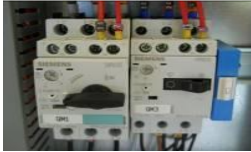
Figura 8 – Interruttori di circuito OFF
