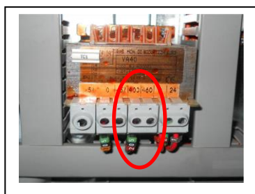
Рис. 5 Трансформатор с 400В
