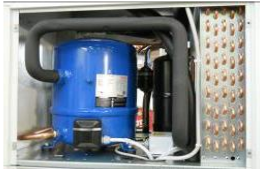
Figure 22 – Position du compresseur
