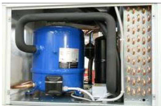
Figura 22 – Posizione del compressore
