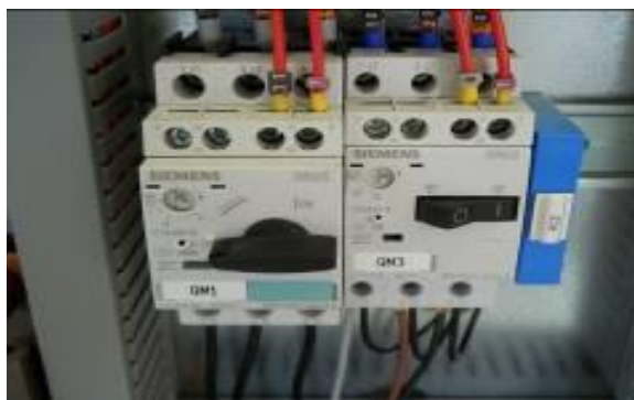
Figura 16 – Interruttore della pompa su ON
