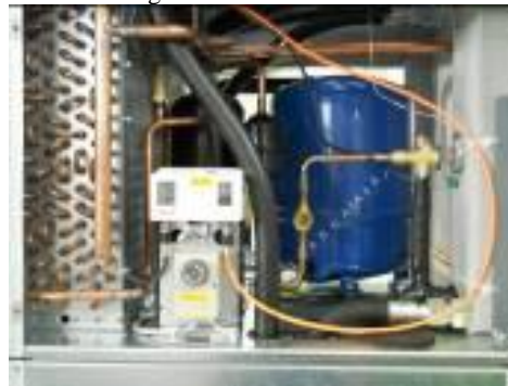
Tubi del refrigerante
