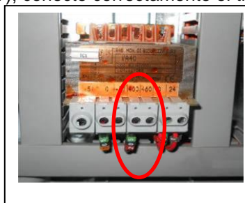
Figura 5 Transformador config. en 400 V
