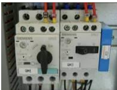
Figura 19 – Interruptores del circuito en ON
