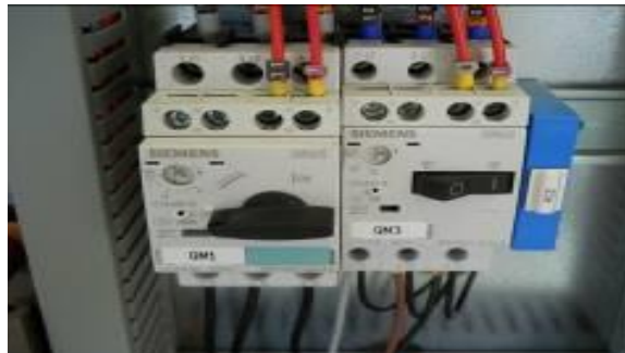
Figure 15 – Interrupteur de la pompe sur ON
