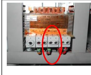
Figure 5 Transformateur réglé sur 400 V
