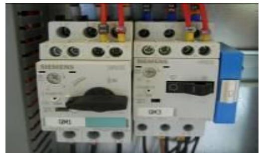
Figura 8 – Interruttori di circuito OFF
