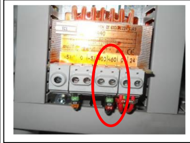
Figure 6 Transformateur réglé sur 460 V
