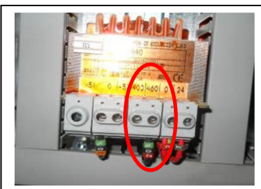
Рис. 6 Трансформатор с 460 В
