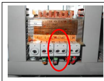
Рис. 5 Трансформатор с 400 В
