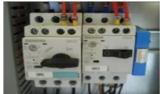
Figura 8 – Interruttori di circuito OFF
