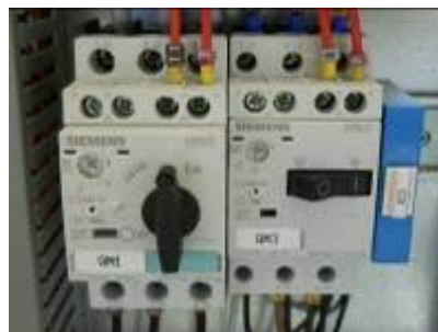
Figure 19 – Tous les interrupteurs de circuit sur ON
