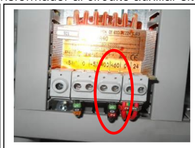
Figura 6 Transformador config. en 460 V
