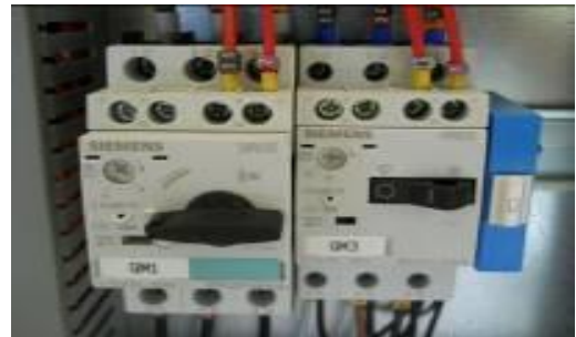
Рисунок 8 – Автоматические выключатели выключены
