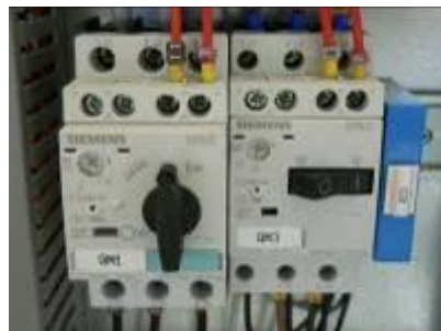
Abbildung 19 – Alle Trennschalter auf ON
