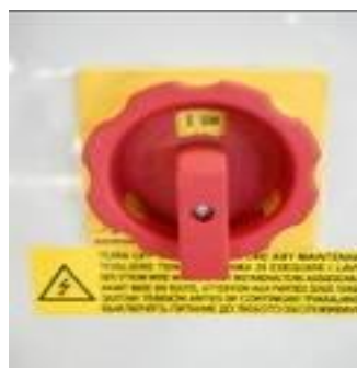
Abbildung 16 – Hauptschalter auf ON
