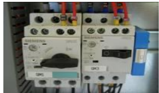
Figura 8 – Interruttori di circuito OFF
