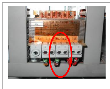
Figura 5 Trasformatore impostato a 400 V
