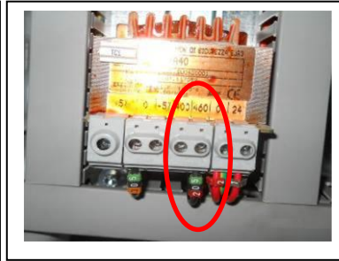
Abbildung 6 Auf 460V eingestellter Transformator
