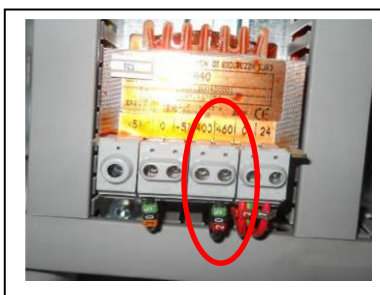
Figura 6 Trasformatore impostato a 460 V
