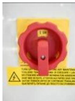
Figura 16 – Interruttore generale su ON
