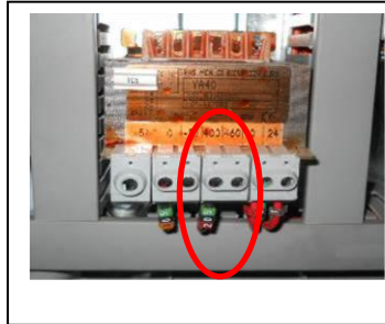
Abbildung 5 Auf 400V eingestellter Transformator
