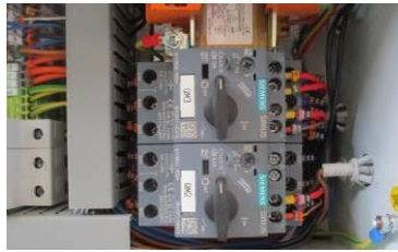
Figure 12 – Interrupteur de la pompe sur ON
