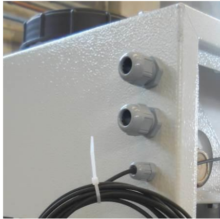
Figure 5 – Plaque pour les raccordements électriques
