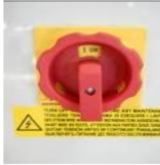
Рис. 13 – Главный выключатель ВКЛ.
