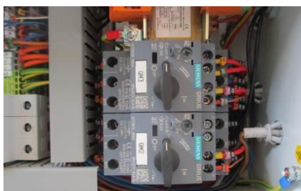
Figura 8 – Interruptores del circuito OFF
