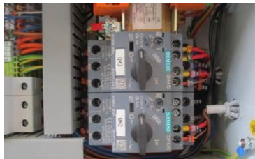
Figura 12 – Interruptor de la bomba en ON
