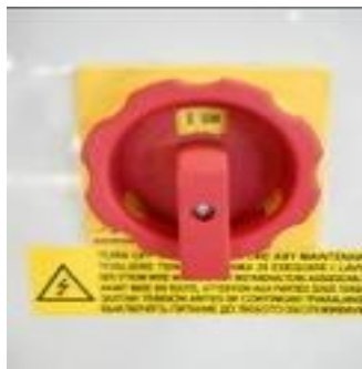
Abbildung 13 – Hauptschalter auf ON
