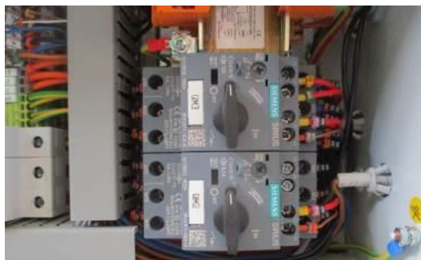
Figura 12 – Interruttore della pompa su ON
