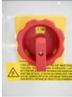
Figura 13 – Interruttore generale su ON
